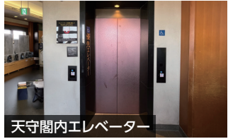
天守閣内エレベーター
